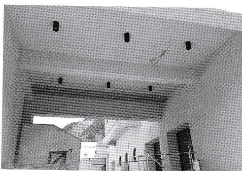
「その他事項」で地震時に落下損傷の恐れが指摘された箇所
