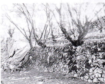
8月25日の本城石垣 石垣真上や横の立木で崩壊やはらみ
