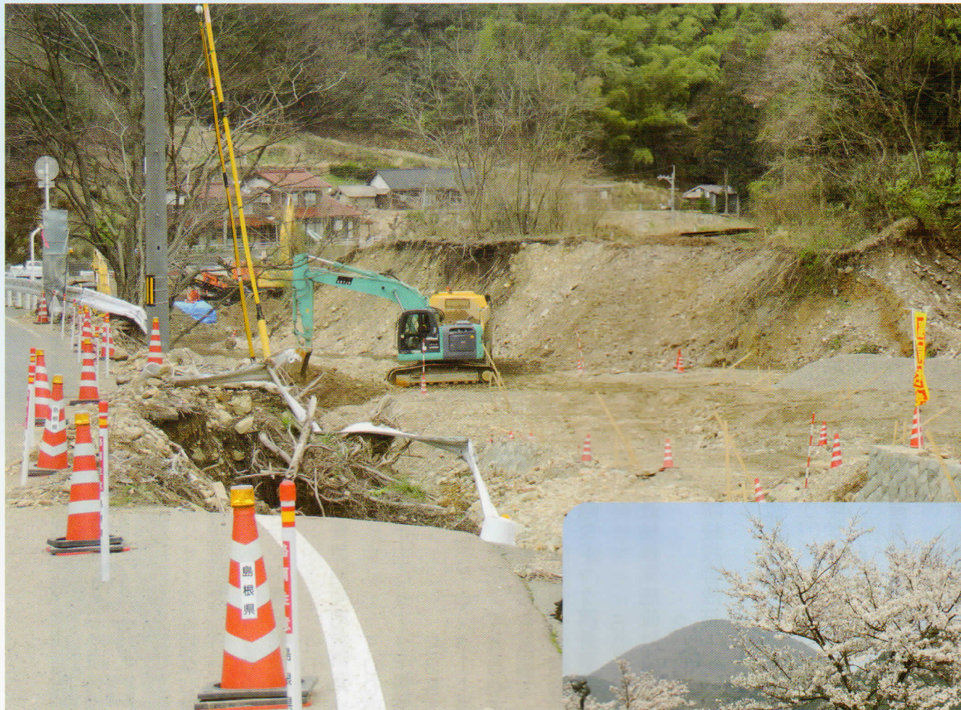
復旧が進む名賀地区
